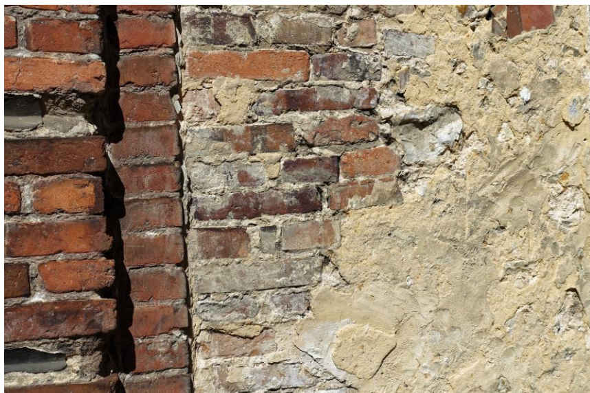
Exemple de mur en brique qui avait été destiné à rester masqué
